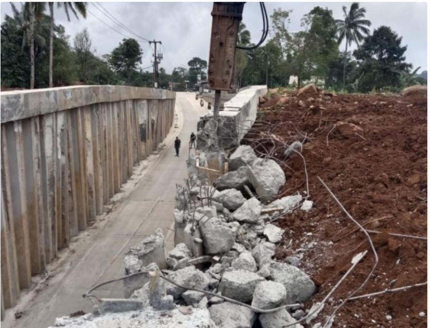
Diduga Proyek Gagal Kontruksi
